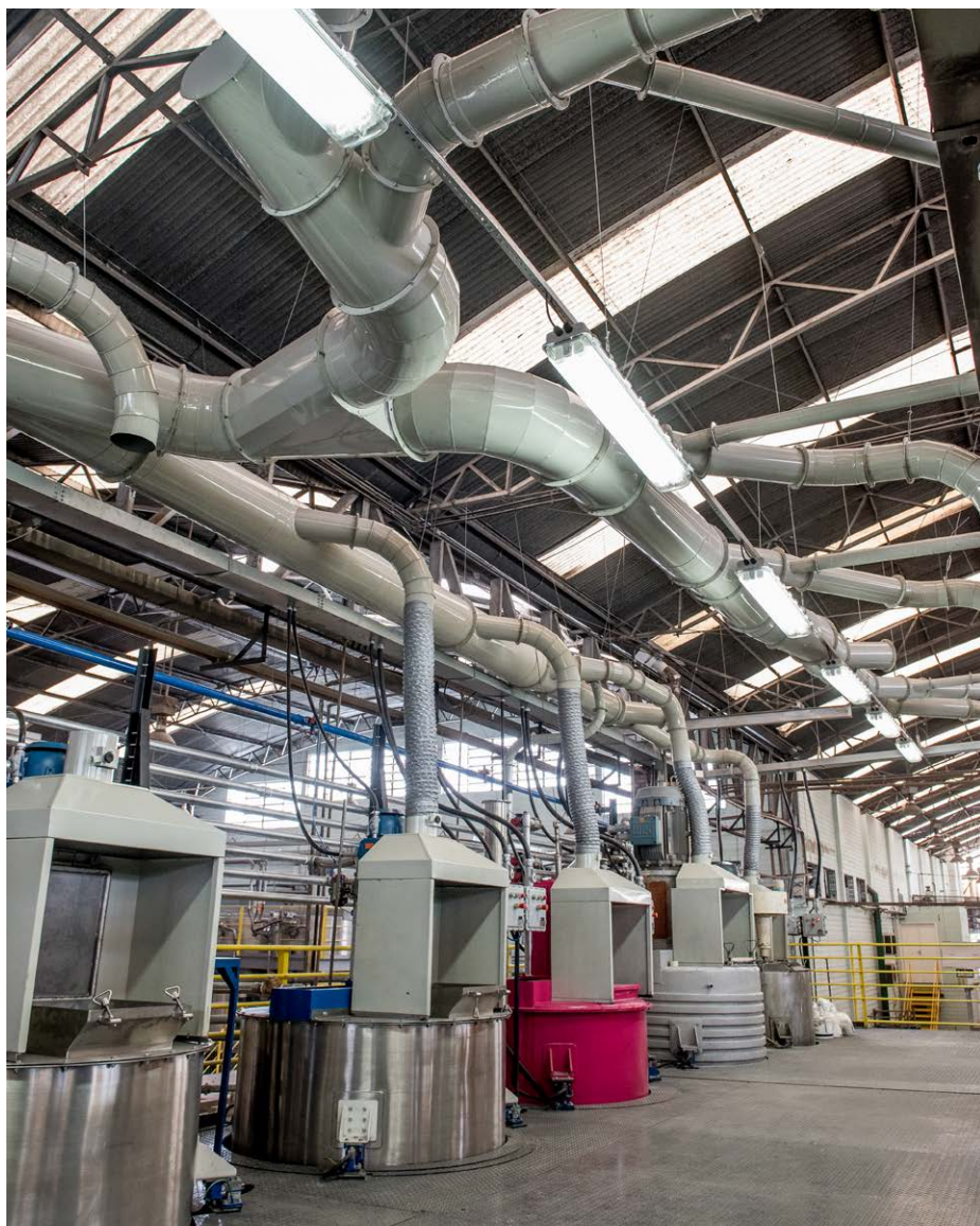
Unidades fabris contam com os mais modernos equipamentos e tecnologia de ponta
